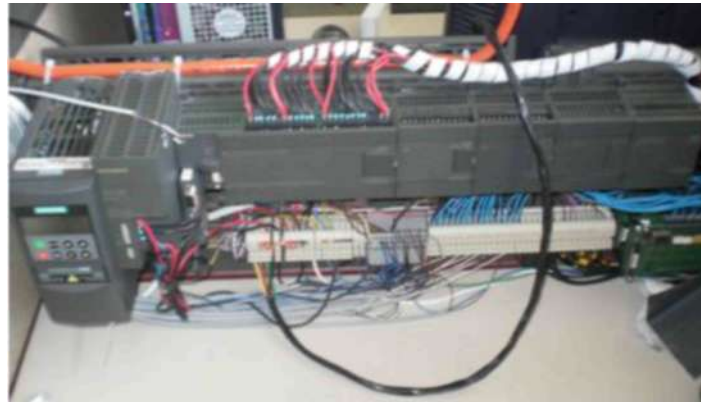
Figura 3.24 Conexión del PLC, cableado eléctrico y neumático.
