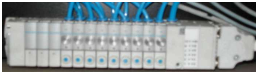
Figura 3.23 Cableado eléctrico y neumático.
