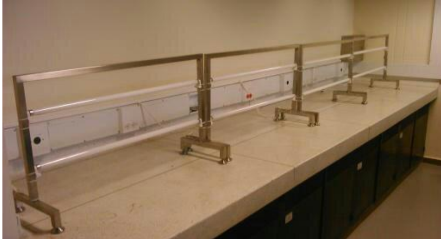
Figura 12. Montaje preliminar del sistema de iluminación
