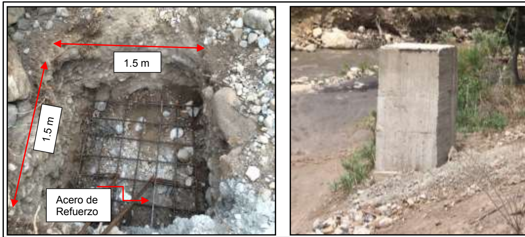
Figura 36. Excavación en conglomerado (Izquierda) de muerto contraviento y Muerto fundido de contraviento (Derecha) de 2.80 m de altura.
