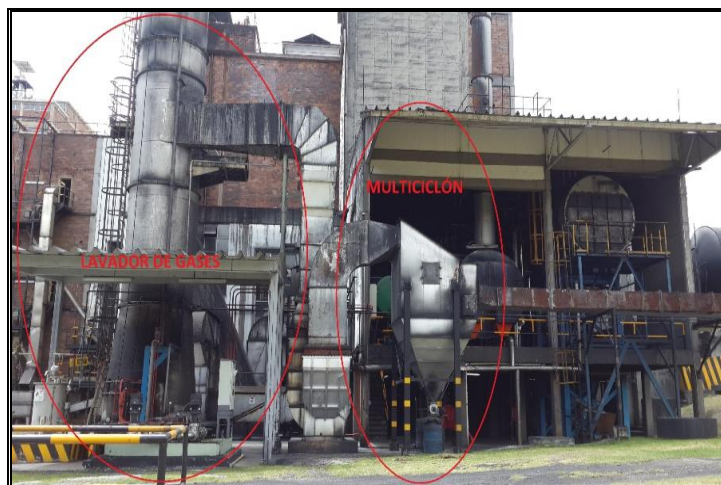
Ilustración 6. Panorámica sistemas de control atmosférico en Caldera VR Fuente: Autor.
