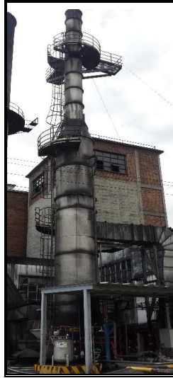
Ilustración 7. Chimenea lavador de gases calderas. Fuente: Autor.
