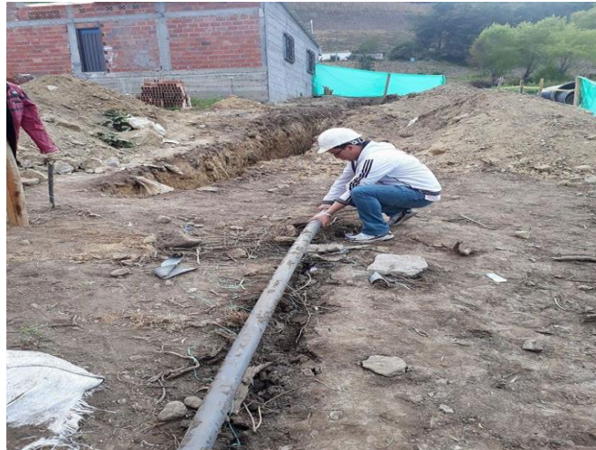
Ilustración 4: Tubería existente a la cual se le realizó modificación en el proyecto del tramo de acueducto. Fuente: Autor.
