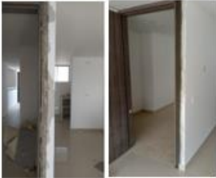
Ilustración 18 Descacila muro de puerta.
