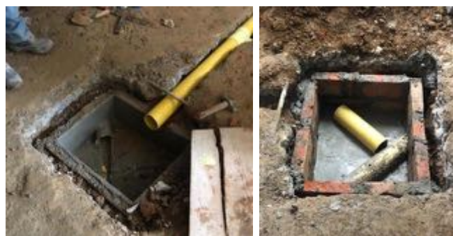
Ilustración 45 Cajas de inspección (Fuente propia)
