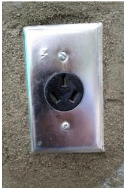
Ilustración 104 Toma trifásica (Fuente propia)
