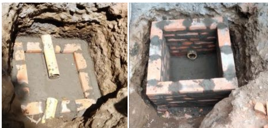
Ilustración 84 Cajas de inspección sanitaria (Fuente propia)
