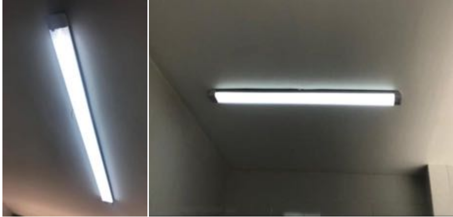
Ilustración 98 Suministro e instalación de Lámpara Fluorescente (Fuente propia)
