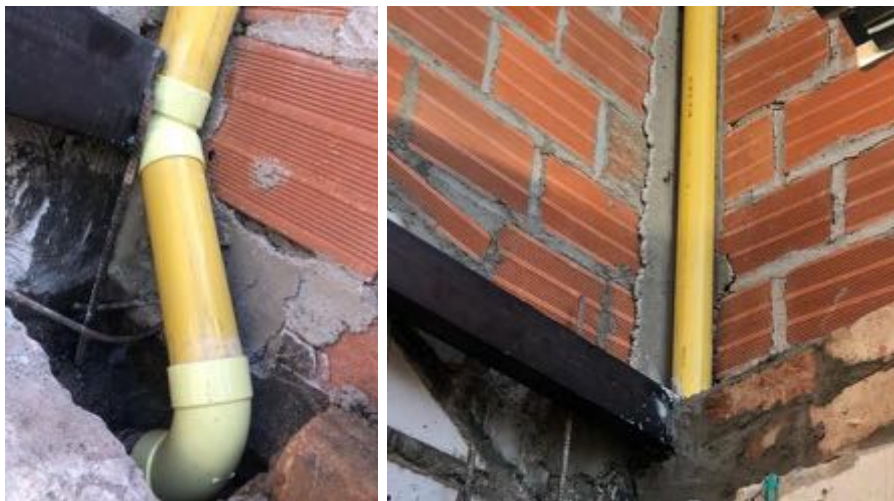
Ilustración 62 Instalaciones hidrosanitarias (Fuente propia).
