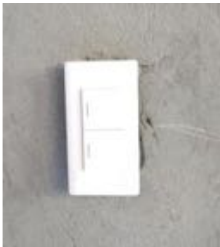
Ilustración 100 Punto electrico para luz interna (Fuente propia)
