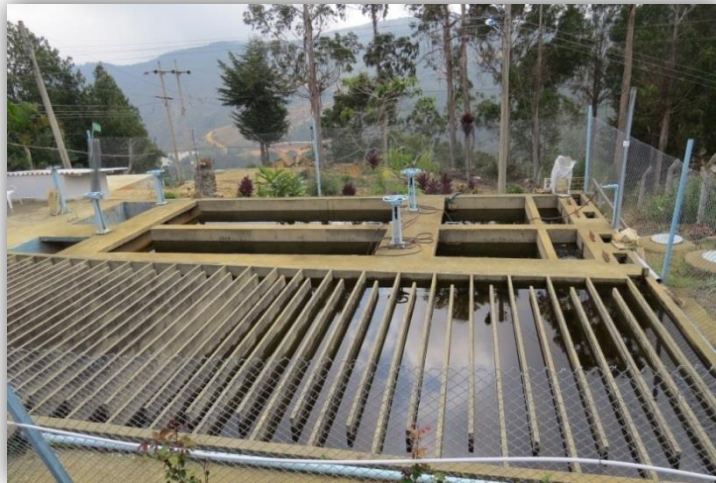
Ilustración 3. Zona de Floculación PTAP-ACUABE
