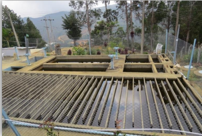
Ilustración 2. Zona de Floculación PTAP-ACUABE
