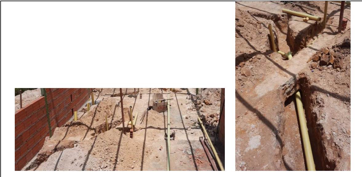
Figura 22. Instalaciones sanitarias de la zona social
