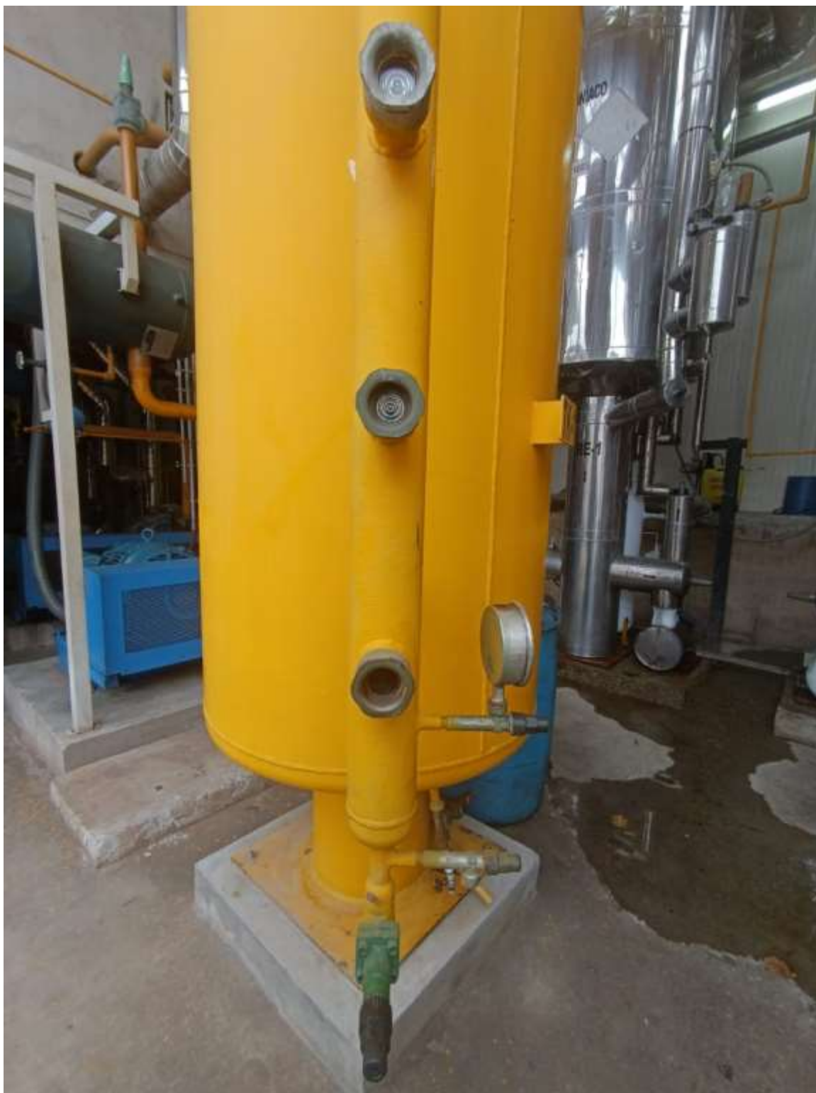
Nivel de tanque acumulador de amoníaco #1
