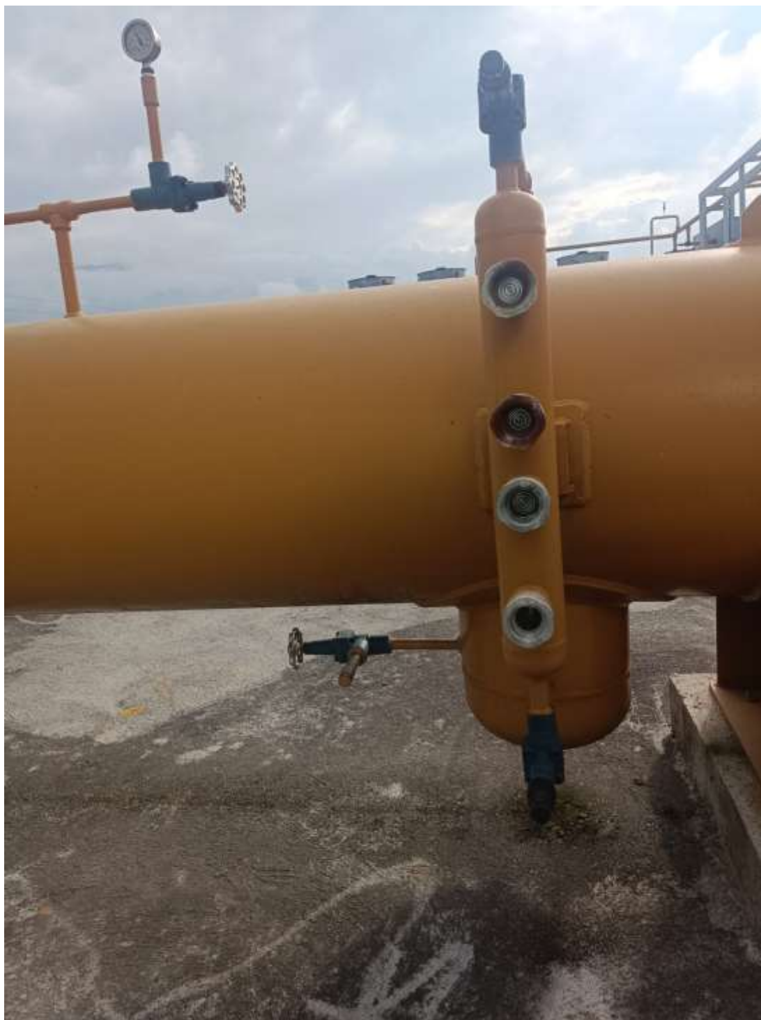
Nivel de tanque acumulador de amoníaco #2
