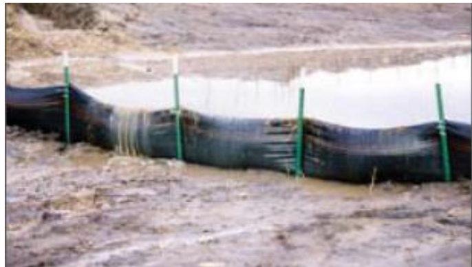
Figura 10: Silt fences.o barrera de sedimentos
