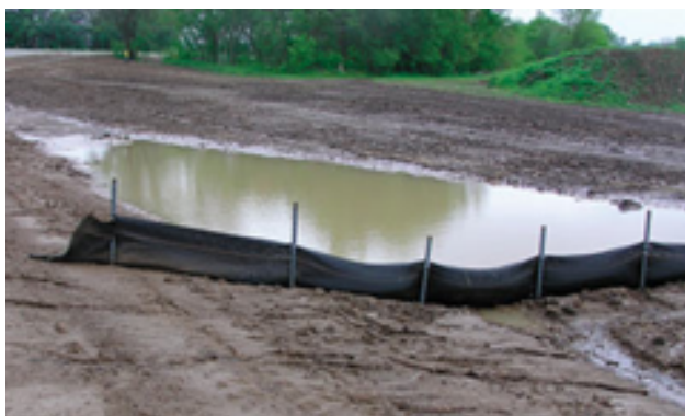
Barrera de sedimentos o Silt Fence.
