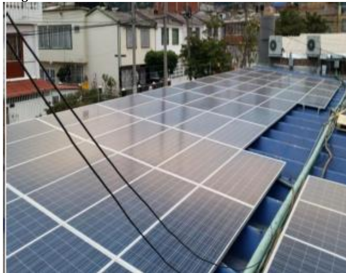
Figura 51 : Paneles solares en una sede administrativa
