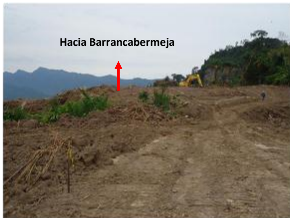
Figura 16. Descapote metros adelante del Puente Caño seco
