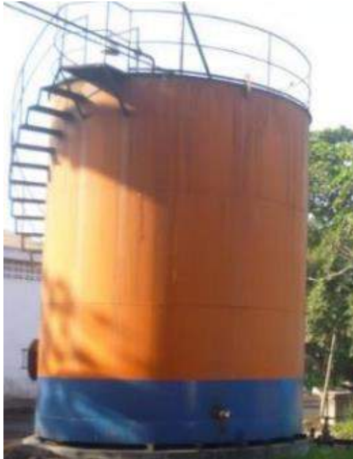
Figura 87 Tanque de almacenamiento de aceite filtrado
