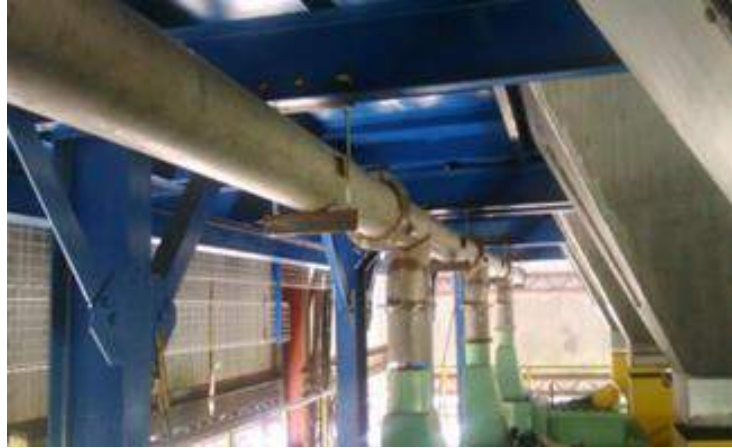
Figura 108 Sistema de ductos de extracción de humos
