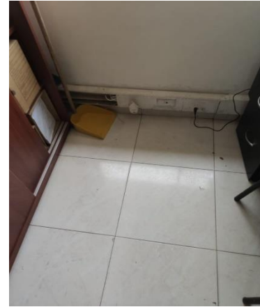
Canaleta metálica abierta.
