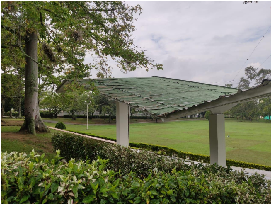
Imagen 40. Estado actual de las tejas en la cubierta del campo de parada.
