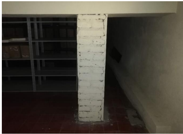
Imagen 6. Estado actual de las columnas que sostienen la plataforma.
