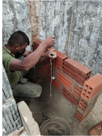
Imagen 20. Revisión de plomo en el levantamiento de un muro divisorio en la zona de los baños
