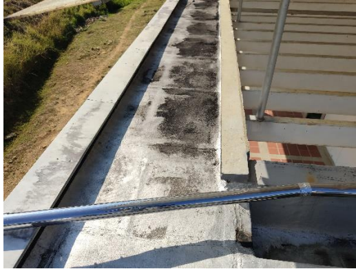
Imagen 32. Estado actual del manto asfáltico que protege la cubierta.
