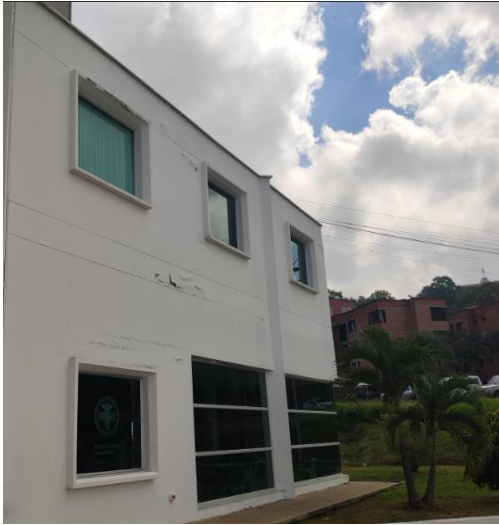
pintura exterior con humedad.
