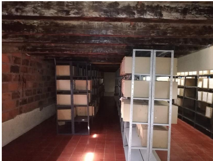
Imagen 5. Estado actual de las vigas que soportan la plataforma y muro sin pañete.
