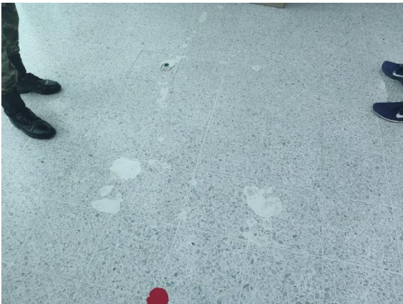
Piso en granito de mármol maltratado.
