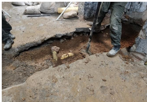
Imagen 19. Compactación de relleno en tierra en la tubería principal sanitaria zona de baños.
