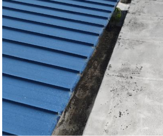
Imagen 34. Deterioro en viga canal.
