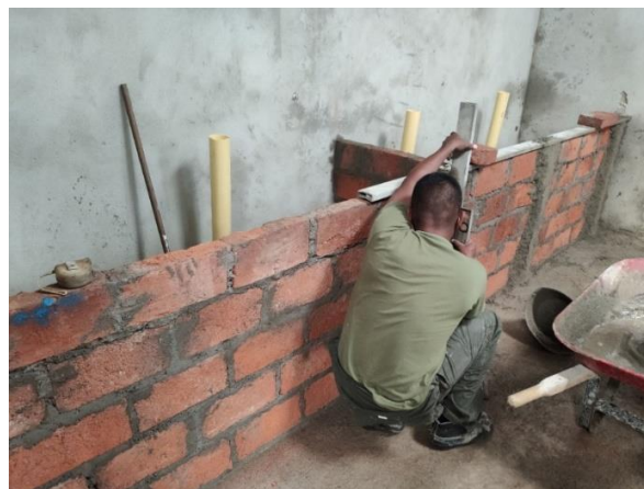
Imagen 21. Construcción y revisión de nivel de muro para los lavaderos en la zona de las duchas.
