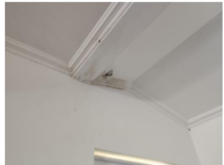
Cielo raso manchado, con caída de pintura.
