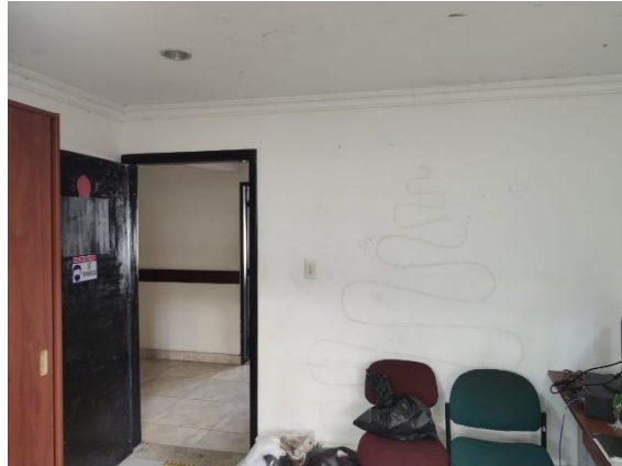
Pintura interior manchada y puerta rayada.
