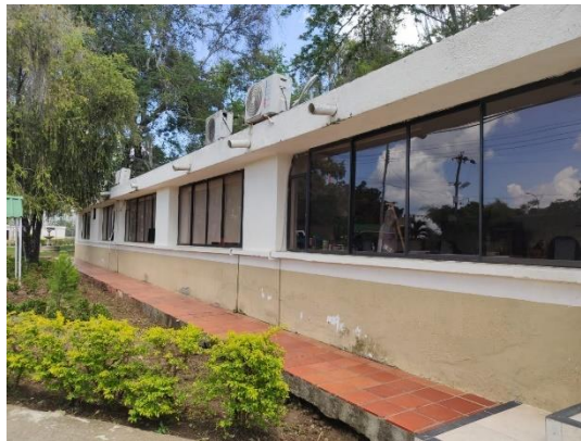
Pintura exterior mancha y desgastada.
