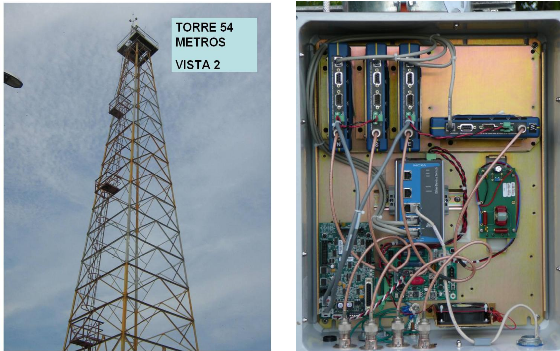
Figura 20. Gabinete P70 con los cuatro radios iNETI para los remotos
