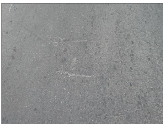
Fisuras sobre la carpeta de rodadura, motivo para el desarrollo de esta actividad
