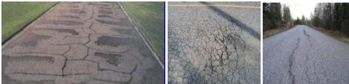
Figura 1. Fallas comunes en pavimento flexible. Tomado de ( Tipos de Fallas en Pavimento Flexible , 2014).
