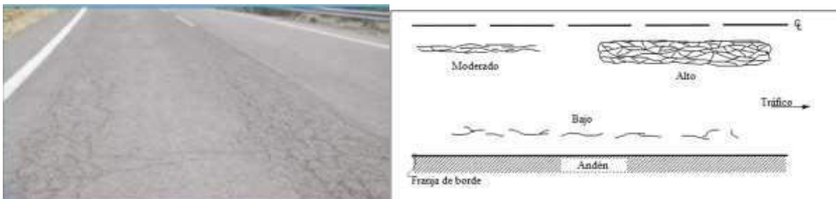
Figura 7. Grietas por fatiga y niveles de gravedad de la fisura. Adaptado al español de (US Department of Transportation, 2014)
