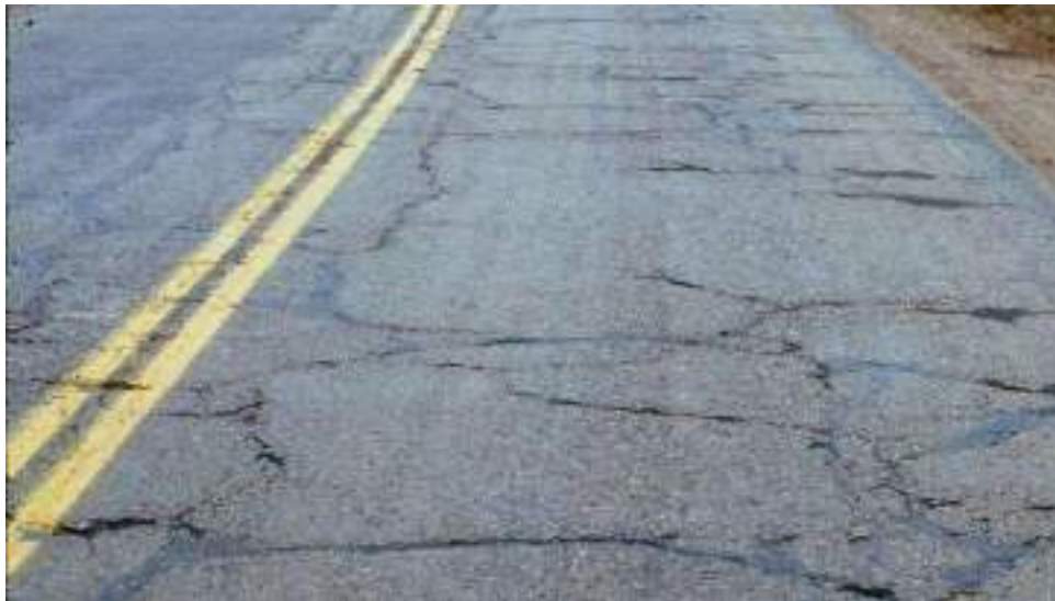
Figura 12. Fisura térmica. Tomado de (Constructora ProyecPlus, 2016)
