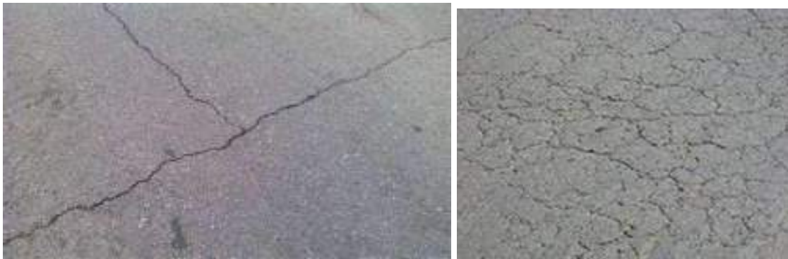
Figura 11. Fisuras estructurales. Tomado de (tecnocarreteras, 2012)
