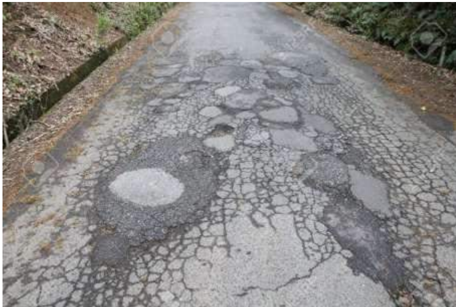
Figura 14. Deterioro de parches. Tomado de (Choquecota, 2020)
