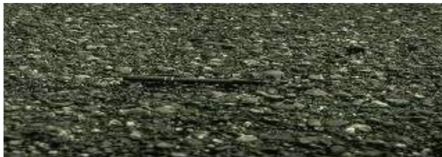
Figura 10. Presencia de agregados en un tramo de vía. Tomado de (Ingeniería Salvador, 2009)
