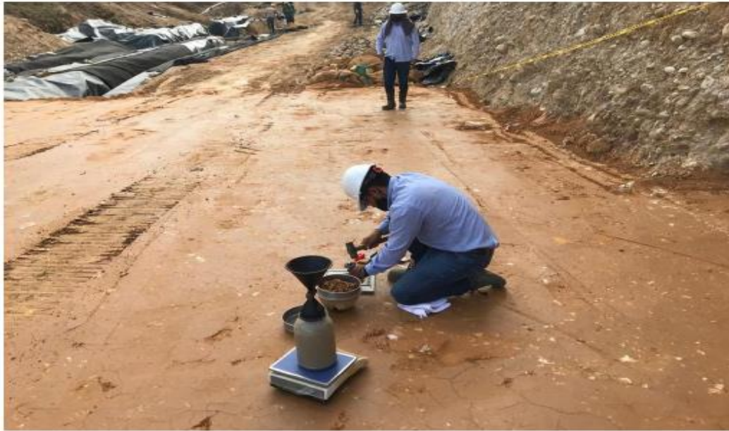
Imagen 8. Ejecución del ensayo de Cono y Arena en la zona de interés.
