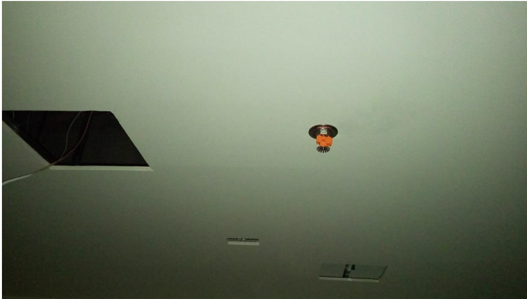
Figura 8 Correspondiente a Etapa 3, Montura de los aspersores y presurizada de red
