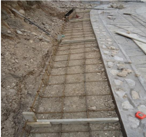
Figura 22 Distribución del hierro en la cuneta
