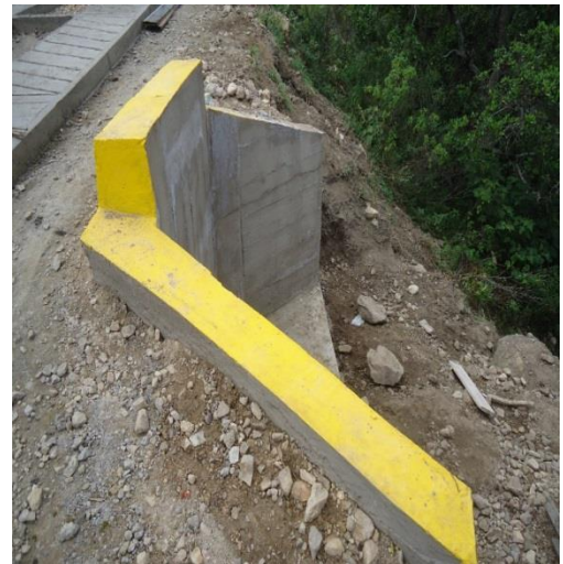
Figura 31 Señalización de cabezote
