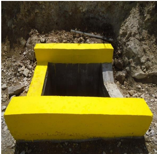
Figura 30 Señalización de poceta
