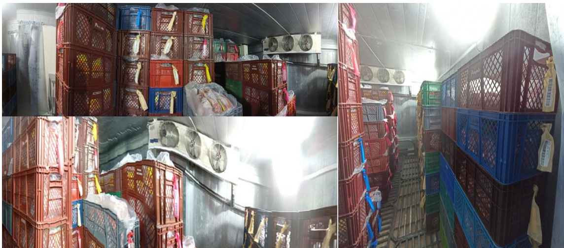
Figura 26. Cava de refrigerado (llena)
