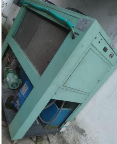
Ilustración 8 Chiller Principal Colfrios
