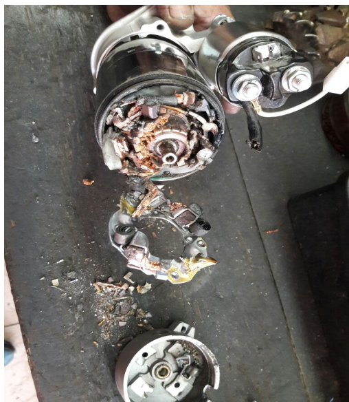
Figura 21. Motor de arranque de una torre de iluminación.
