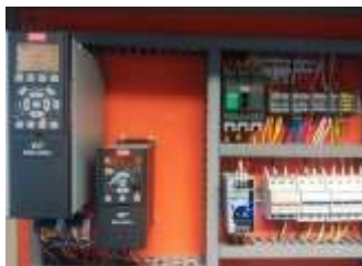
Figura 12. Variadores de Velocidad.
