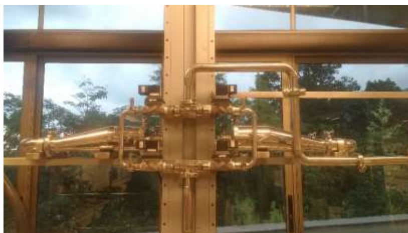
Figura 17. Probador Bidireccional UPB ya instalado
