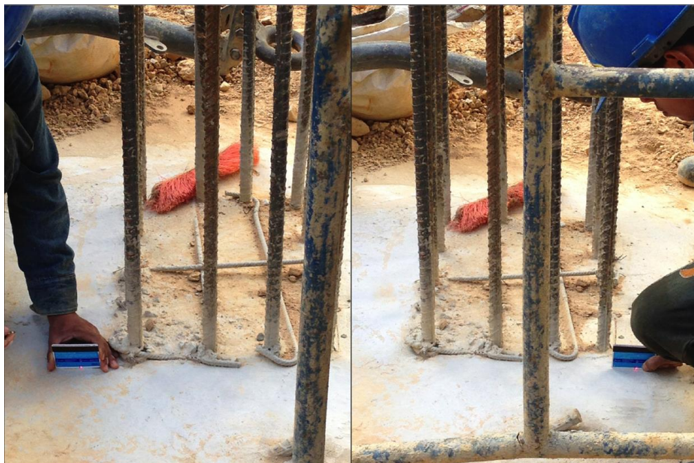
Foto 80 Demarcado de las caras de la formaleta, eje de referencia y sección de concreto de la columna.
