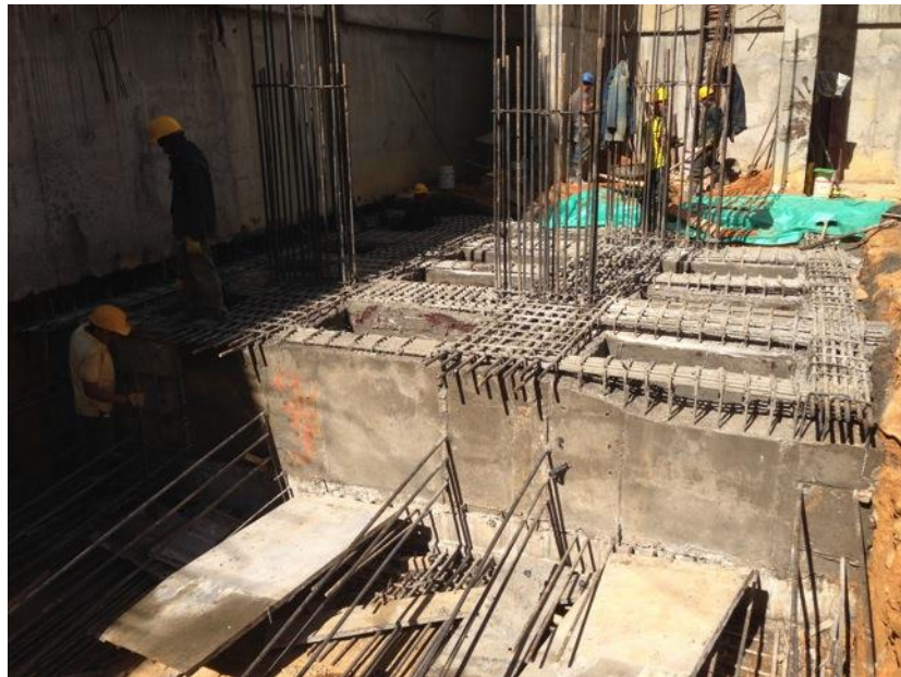
Foto 66 Terminado de la segunda junta horizontal de construcción (ejecución secciones de vigas cimiento y viguetas).
