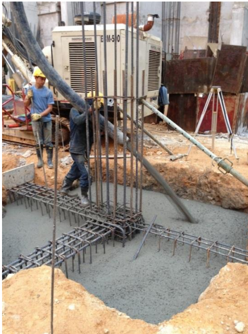
Foto 17 Vaciado y ejecución de la zapata D-6, vigas de amarre y arranque de la columna T-7.
