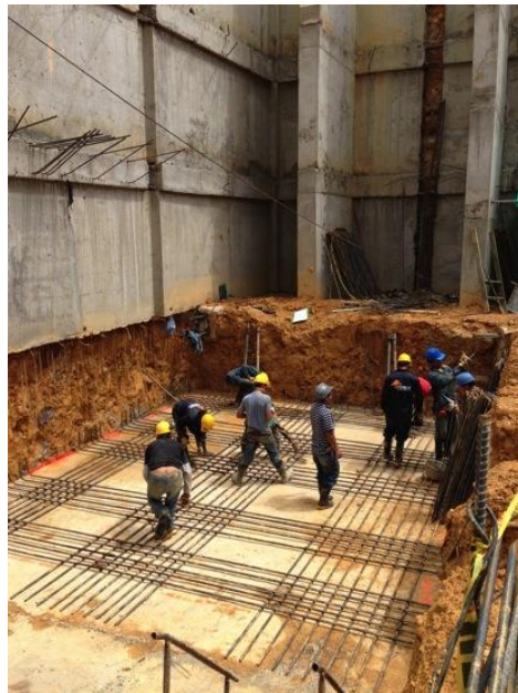
Foto 56 Armado de la parrilla inferior perteneciente a la placa inferior según especificaciones.
