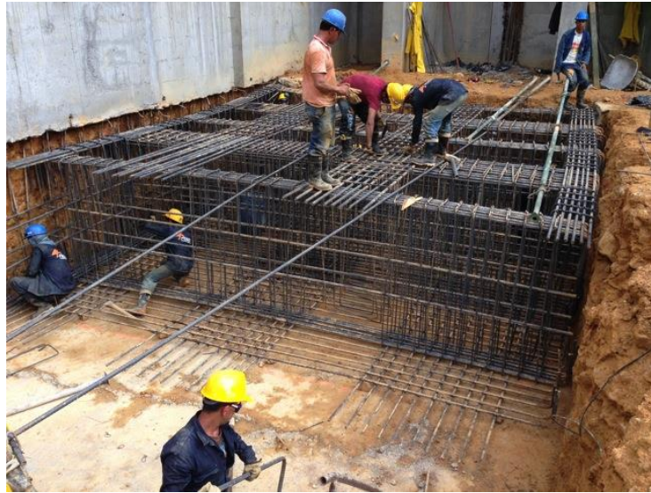
Foto 59 Introducción de acero longitudinal superior y estribos para vigas cimiento y viguetas en sentido contrario.
