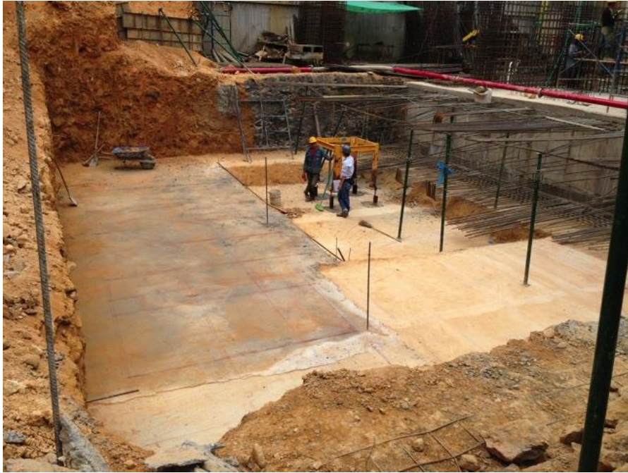
Foto 72 Foso de ascensores principales, se observa la cimentación en acero de la torre grúa, la cual quedará embebida.
