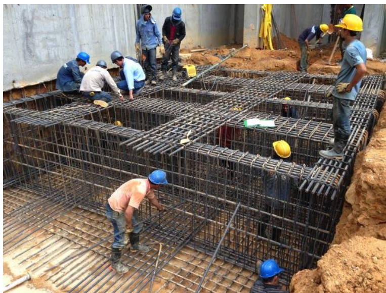
Foto 60 Introducción de acero longitudinal inferior de vigas cimiento y viguetas en sentido contrario.
