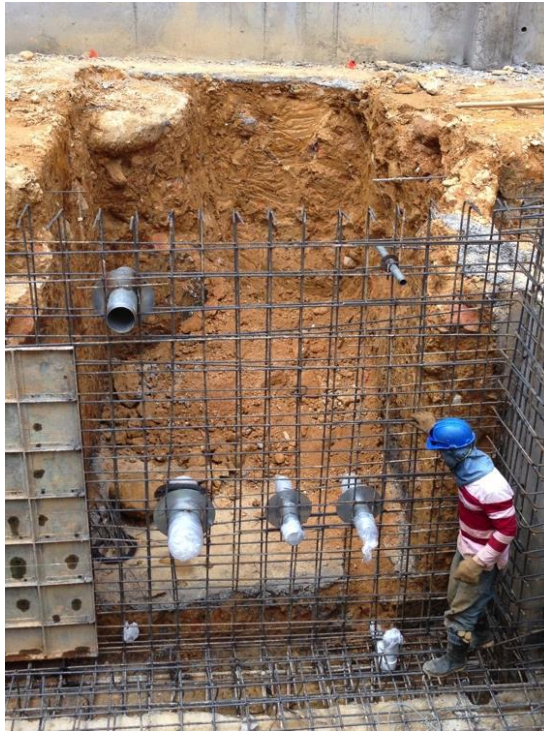
Foto 41 Pases de tubería que se dejaron embebidos en el muro y conectan en el cuarto de máquinas.
