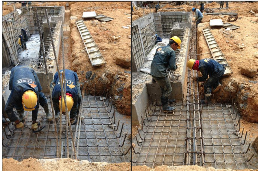
Foto 75 Introducción y armado del acero de refuerzo para zapata y vigas de amarre contiguas al elemento de fundación.
