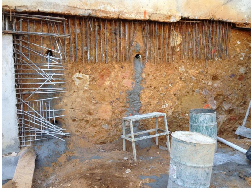
Foto 21 Introducción en las perforaciones del acero de refuerzo e inyección de la lechada.
