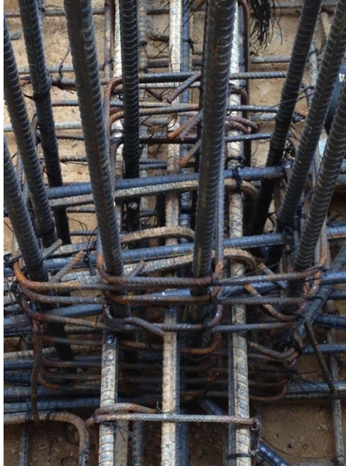
Foto 79 Aspecto visual de los estribos del nodo y el acero longitudinal de la columna.
