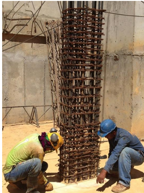
Foto 81 Introducción y amarre de los estribos y ganchos correspondientes a la columna.
