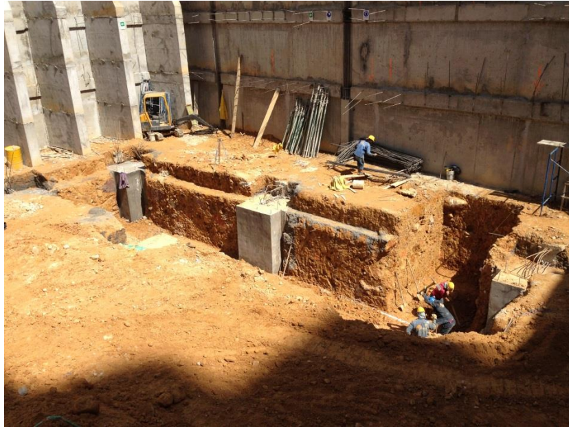
Foto 37 Aspecto del tanque subterráneo con los 6 ciclópeos perimetrales vaciados y la excavación del cuarto de máquinas.
