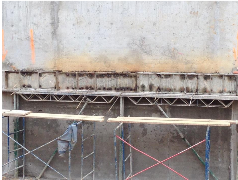
Foto 28 Instalación de la formaleta metálica para el vaciado de la viga superior.
