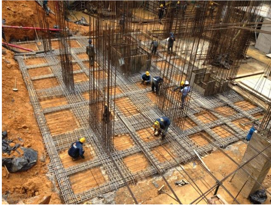
Foto 74 Relleno del aligeramiento con suelo, armado de parrillas para la placa superior.
