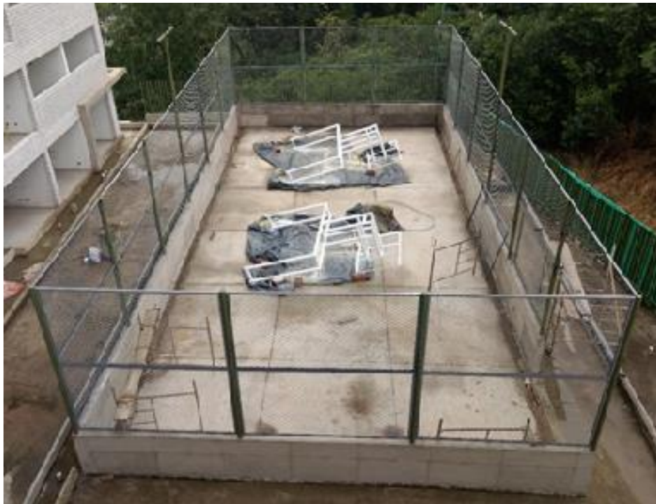
Figura 49. Cancha múltiple con malla instalada
