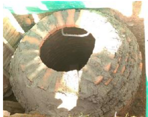
Figura 17. Cono de Reducción pozo de inspección
