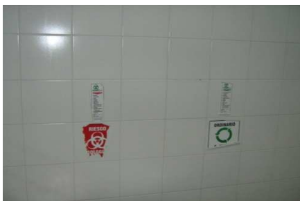
Imagen 5. Etiquetas deterioradas y sin recipientes.
