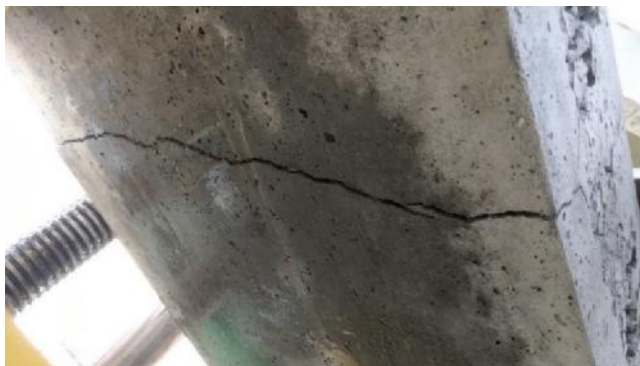
Ilustración 44. Falla inferior placa con botellas
