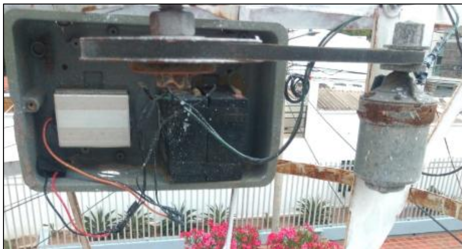
Figura 30. Sistema de generación eléctrica
