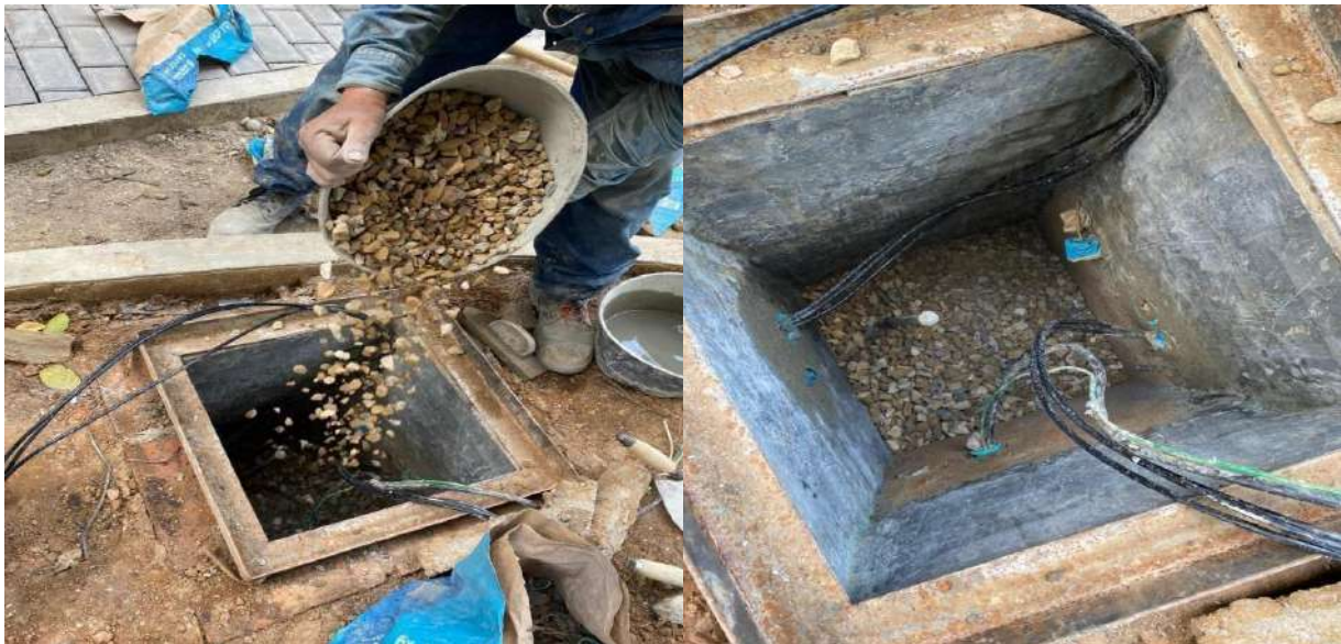
Figura 26. Triturado para las cajas eléctricas
