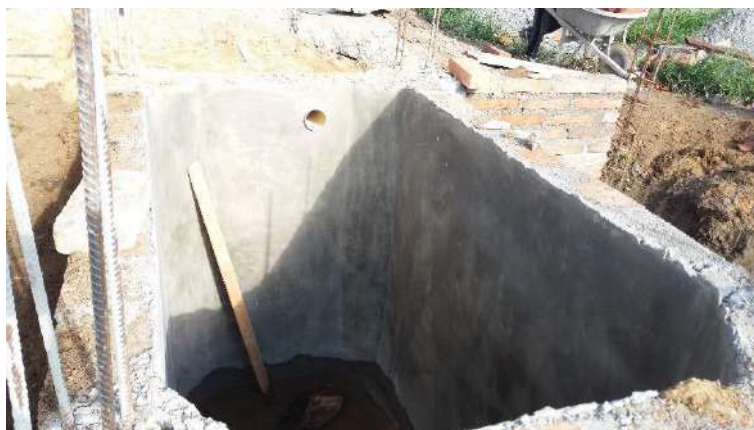
Fotografía 42 – Tanque de Agua para Almacenamiento, Fuente: Propia
