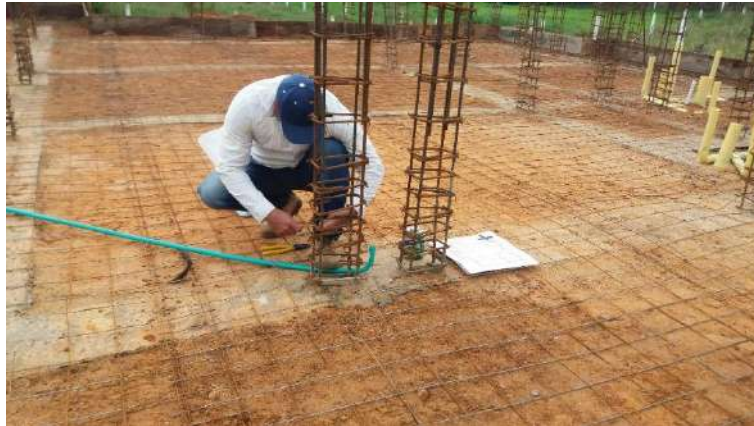
Fotografía 22 – Instalaciones Eléctricas, Fuente: Propia
