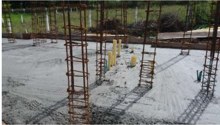
Fotografía 19 – Instalaciones Hidrosanitarias y Gas, Fuente: Propia
