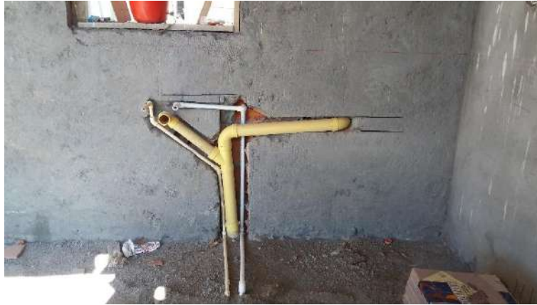
Fotografía 59 – Instalaciones Hidrosanitarias, Fuente: Propia
