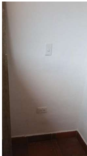
Fotografía 75 – Instalaciones Eléctricas Finales, Fuente: Propia
