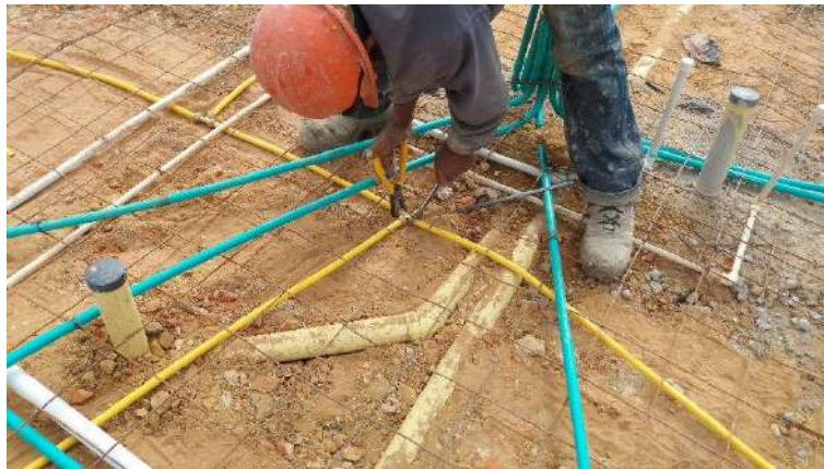
Fotografía 20 – Instalaciones Hidrosanitarias y Gas, Fuente: Propia
