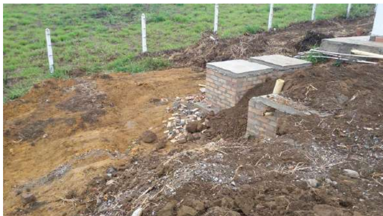
Fotografía 41 – PTAR, Fuente: Propia
