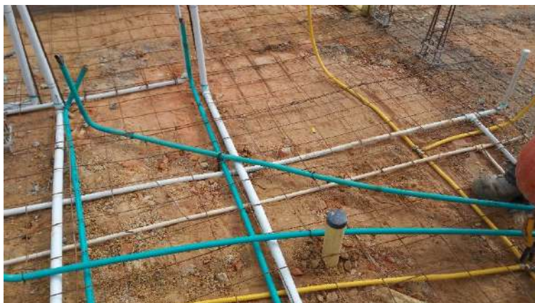
Fotografía 23 – Instalaciones Eléctricas, Fuente: Propia
