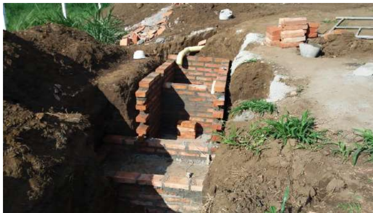
Fotografía 40 – PTAR, Fuente: Propia
