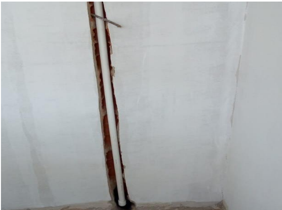
Imagen 19. Desagüe de aires acondicionados.
