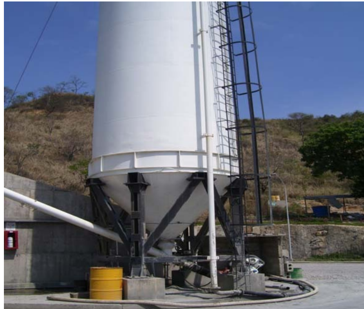
Figura 5. Silos de Cemento.
