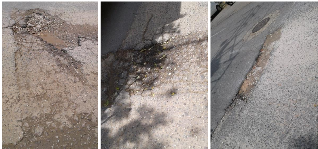
Imagen 1. Daños presentes en la red vial.
