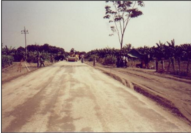
Imagen 5. Trabajos de céreo del terraplén, antesala para el montaje de la vía.
