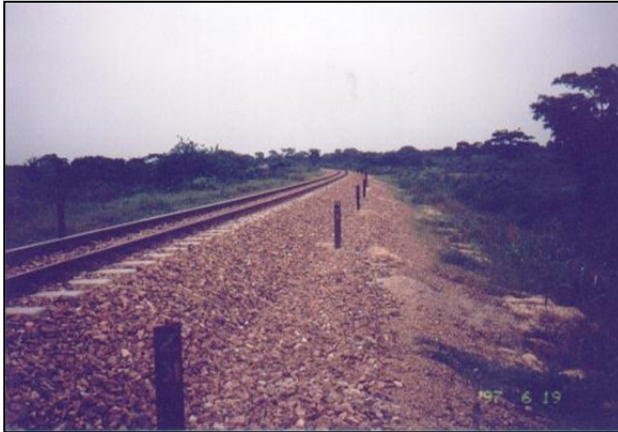
Imagen 70. Piquetes de referencia en los cuales se materializa la geometría de la línea férrea.
