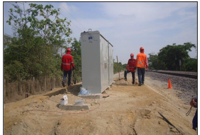
Imagen 95. Gabinetes de control ubicados en la zona de estaciones
