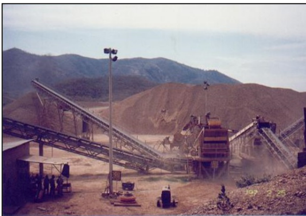
Imagen 48. Trituradora para obtener el balasto y sub-balasto del proyecto localizada en la cantera Ley de Dios (Cesar).
