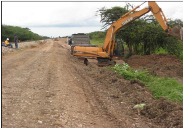
Imagen 76. Inicio de la construcción de la vía paralela a la 1ª línea nueva. Trabajos de descapote, retiro de material vegetal y de la estructura antigua
