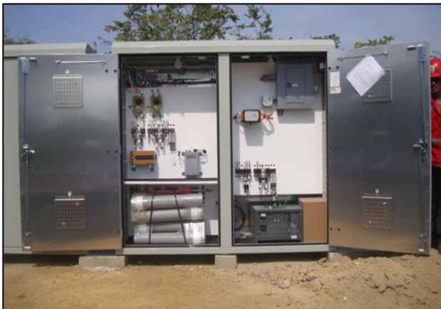
Imagen 94. Gabinetes de control ubicados en la zona de entrada a los apartaderos
