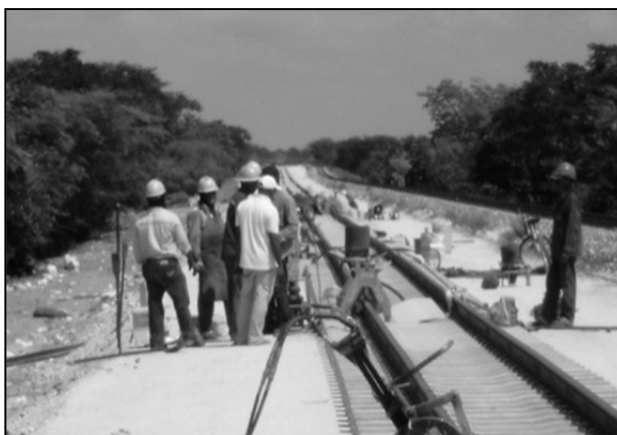
Imagen 80. Montaje de los equipos para la unión de los rieles con soldadura aluminotérmica
