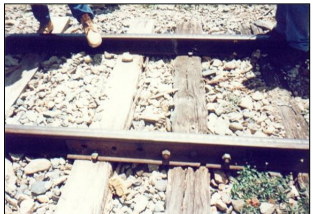
Imagen 2. Estado inicial de la línea a rehabilitar. Obsérvese el mal estado de las traviesas y la falta de elementos en las platinas de unión
