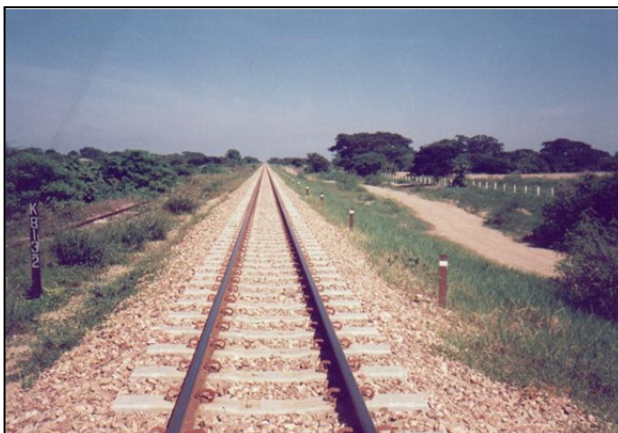
Imagen 74. Resultado final del trabajo de recuperación de la vía férrea. Obsérvese los postes kilométricos y los piquetes de referencia.
