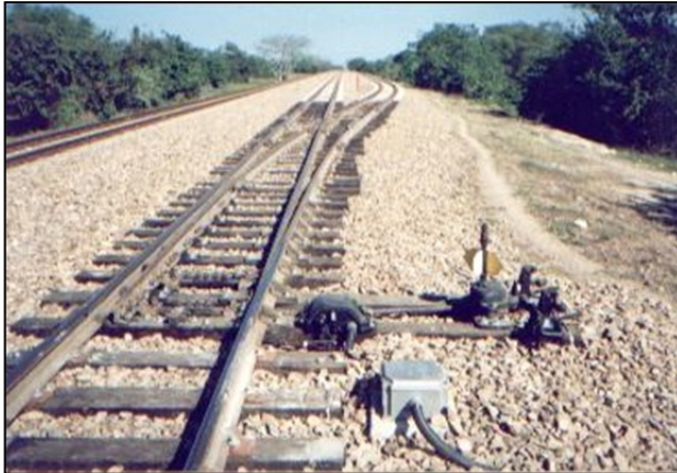
Imagen 92. Detector de punta de agujas instalado en los cambiavías hacia línea tercera en los apartaderos
