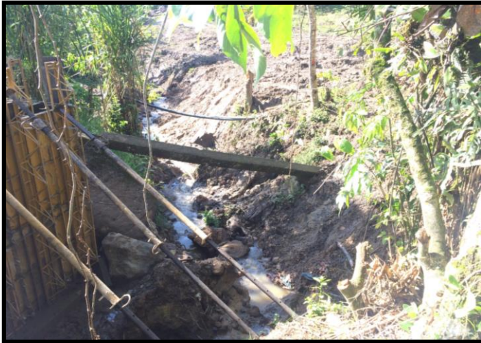
Figura 152: Derrumbe en el canal de la quebrada BARINAS
