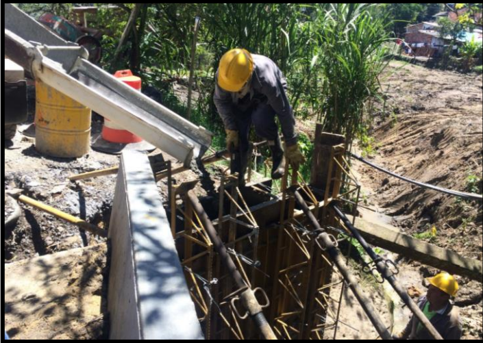
Figura 148: Fundida de la aleta de salida del muro lateral izquierdo del BOX COULVERT N°1
