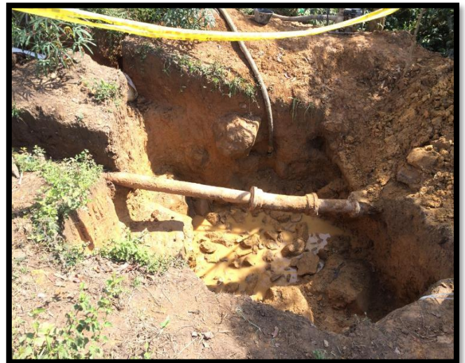
Figura 155: Filtración en la excavación del contrafuerte N°1
