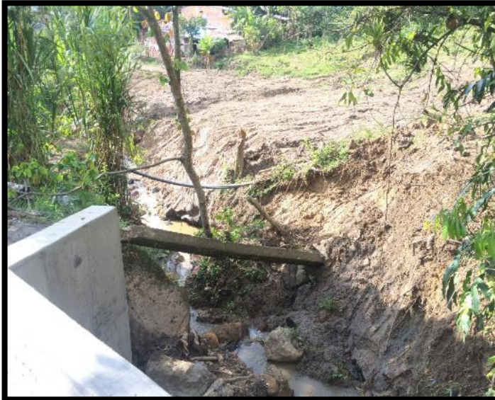
Figura 167: Derrumbe en el canal entre las abscisas Ko+130 – Ko+125
