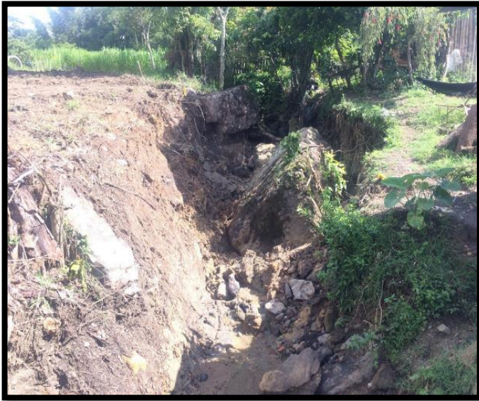
Figura 161: Deslizamiento de roca y derrumbe entre las abscisas Ko+110- Ko+105
