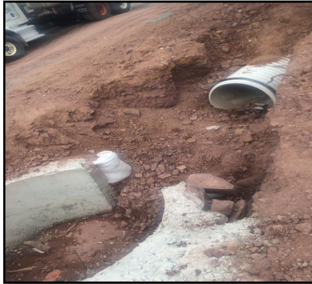
Figura 35: tubo y pozo faltante
