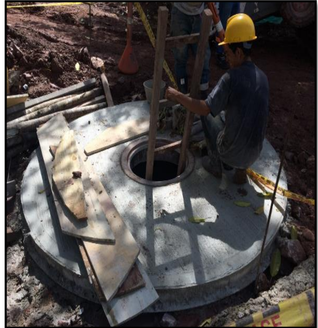
Figura 34: Corona de pozo de inspección
