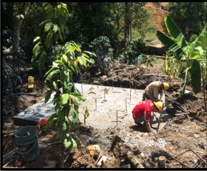
Figura 132: Anclado de hierro para el pósito A
