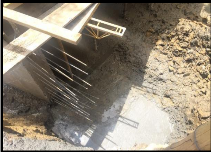
Figura 110: solado para aleta de entrada en el muro lateral izquierdo del BOX- COULVERT N°1
