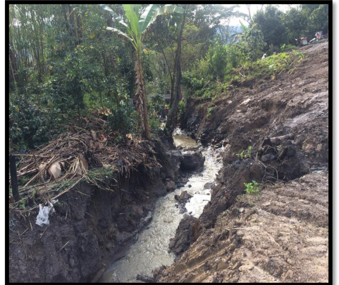
Figura 168: Derrumbe en el canal entre las abscisas Ko+135 – Ko+160
