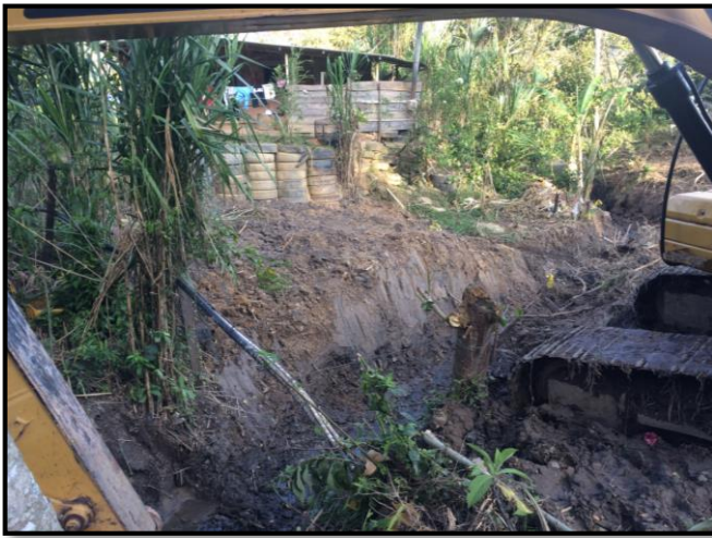
Figura 86: Excavación con máquina del canal y relleno al lado de la casa de Sr. RAMIRO FONSECA
