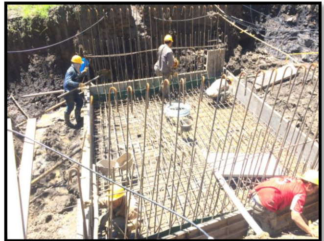
Figura 147: instalación de acero de refuerzo, cinta de PVC y formaleta para la placa piso del BOX COULVERT N°1
