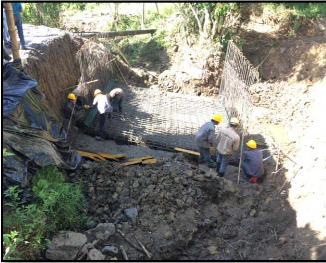
Figura 71: Armado de acero de refuerzo para la placa del BOX COULVERT N°1
