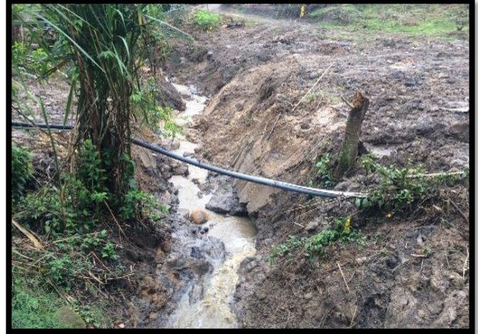
Figura 113: derrumbe en el canal
