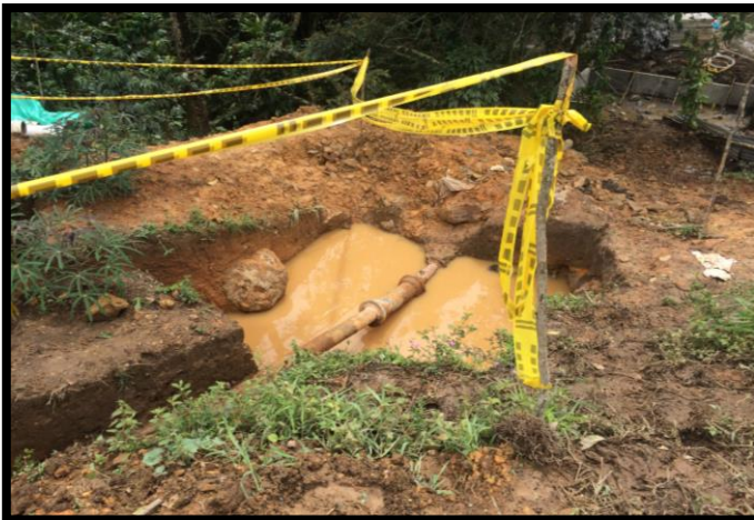
Figura 134: Inundación en la excavación del contrafuerte n°1
