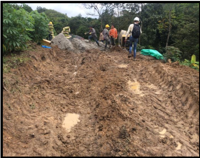
Figura 126: Saturación en el terreno de la entrada al acopio de materiales
