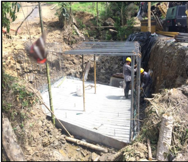
Figura 84: Armado de acero de refuerzo del muro ubicado en el sentido Sureste
