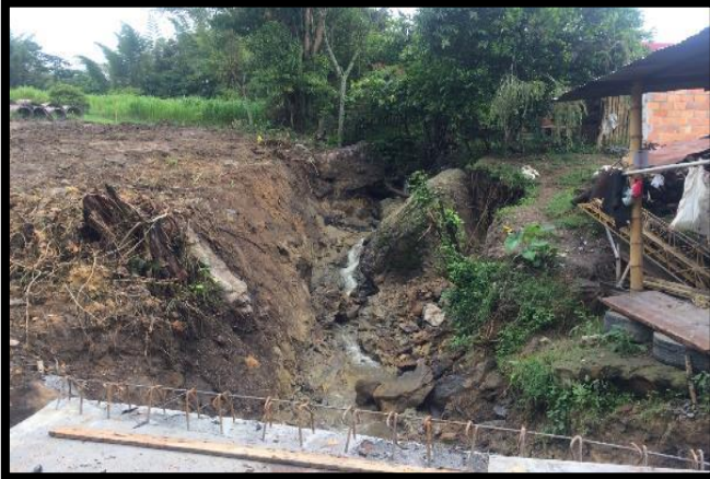
Figura 114: deslizamiento de roca
