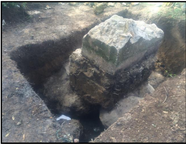
Figura 63: filtración de agua en la excavación del pórtico A
