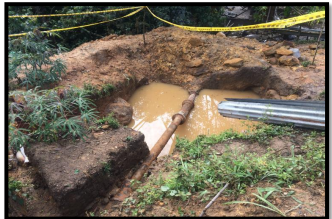
Figura 157: Inundación en la excavación del contrafuerte N°1
