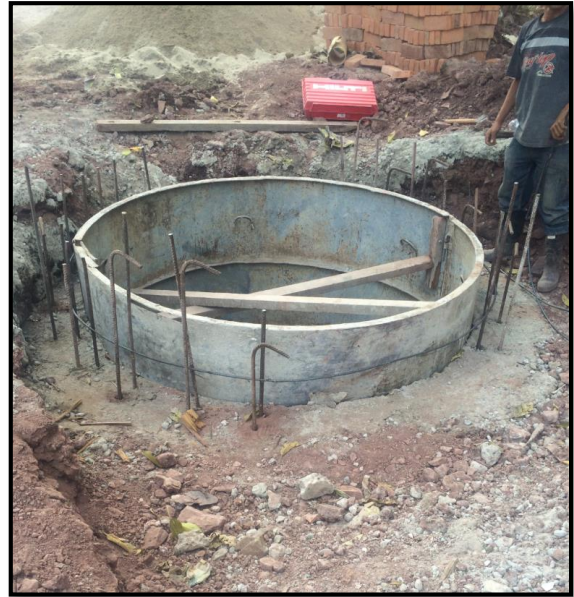
Figura 33: cilindro pozo de inspección
