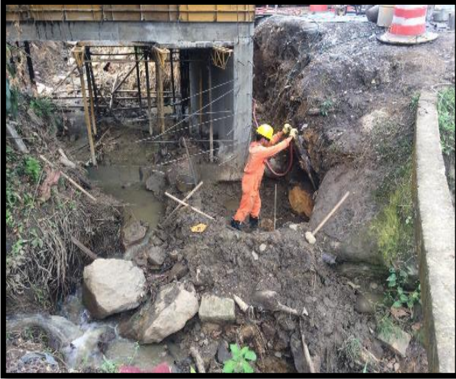
Figura 116: demolición de roca en la excavación de la zarpa para la aleta de salida del muro lateral izquierdo
