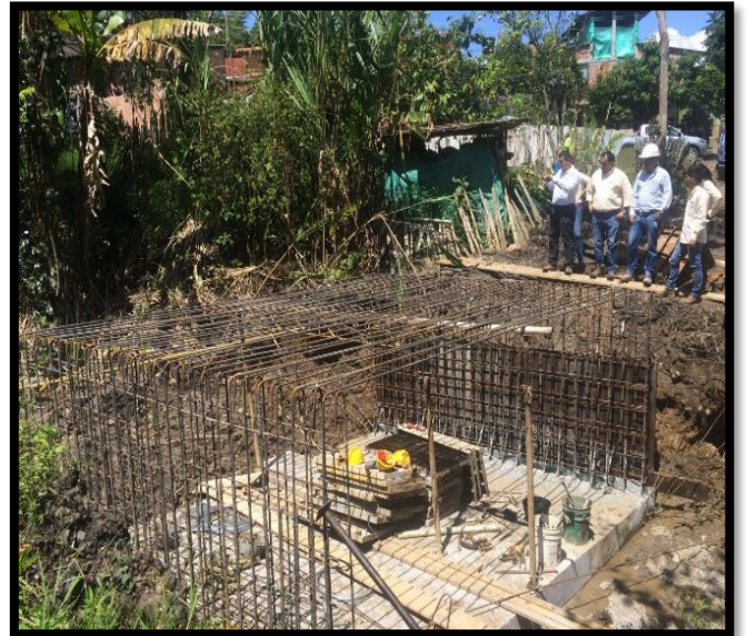
Figura 162: Instalación de acero de refuerzo y formaleta para los muros del BOX COULVERT N°2
