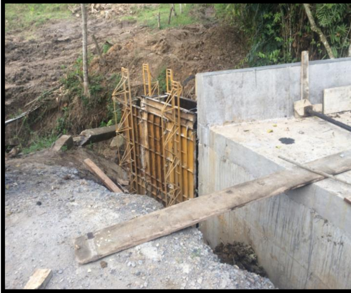
Figura 140: Instalación de formaleta para la aleta de salida del muro lateral izquierdo del BOX COULVERT N°1
