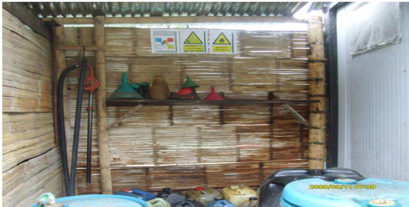
Foto 12. Centro de Acopio de Combustibles.
