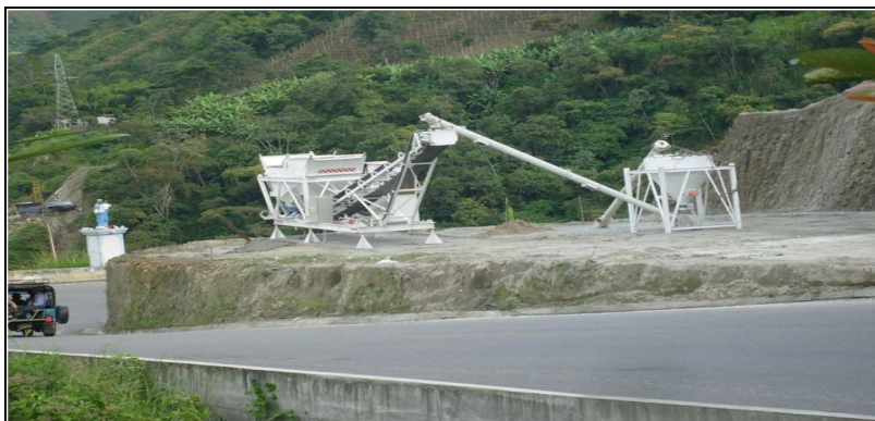
Foto 14. Dosificadora de Concreto.
