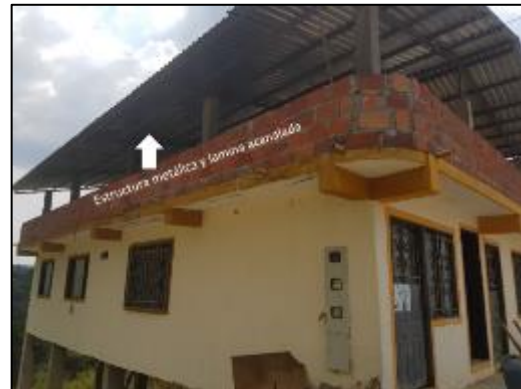
Fotografía 16. Ubicación estructura metálica y teja en madera y teja en edificación del municipio de Ocamonte
