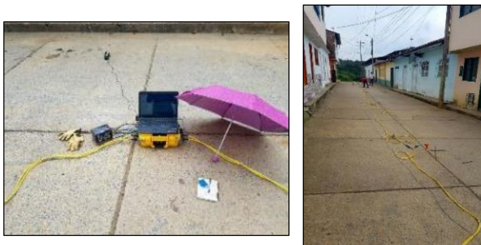
Fotografía 2. Instalación en campo del cableado, equipo y ordenador
