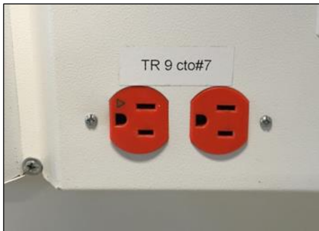
Figura 18. Toma corrientes de energía auxiliar
