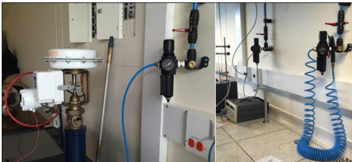
Figura 103. Filtros reguladores instalados en el laboratorio de instrumentación
