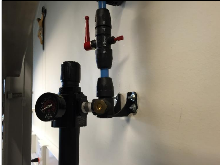
Figura 16. Regulador y conexión de aire comprimido
