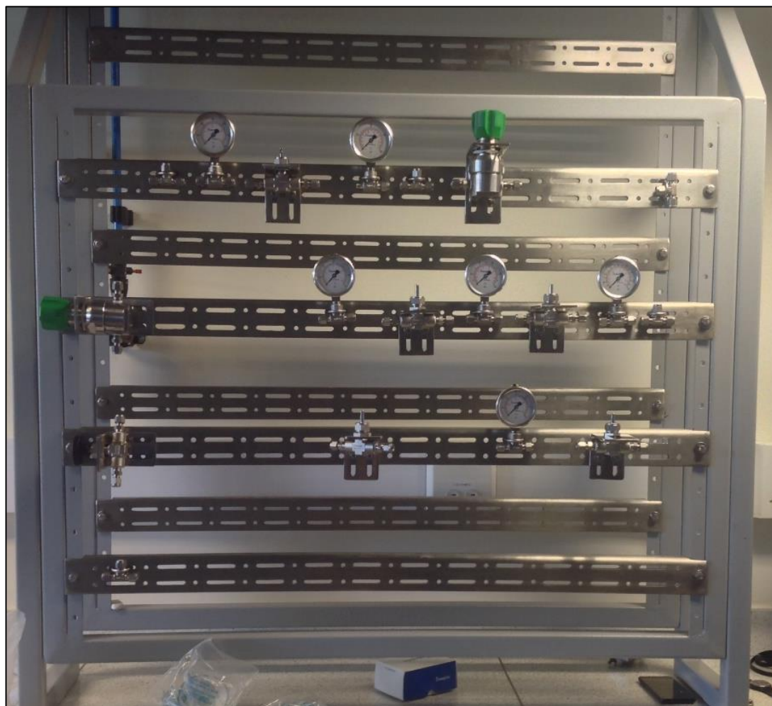
Figura 47. Manómetros, válvulas y reguladores instalados en el marco del módulo
