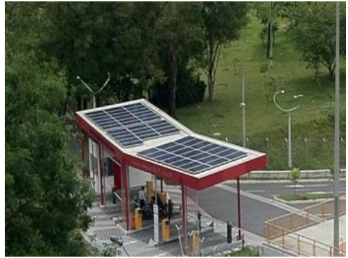
Fig. 12. Sistemas SFV techos entradas peatonal (arriba) y vehicular.
