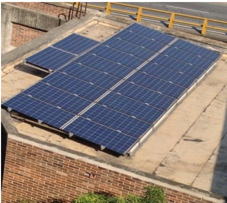
Fig. 8. Sistema de generación SFV bloque 10.
