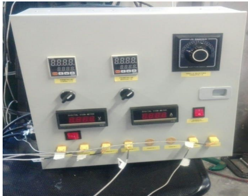
Figura 10. Caja de control
