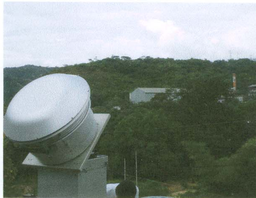
ESTACION DE MONITOREO No.2, ATRÁS SE NOTA LA PLANTA.
