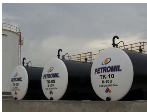
Figura 16. Área de tanques horizontales, contienen Bío-diesel 100%
