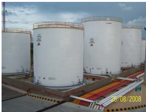
Figura 15. Área de tanques verticales, cuatro de ellos contienen ACPM, dos gasolina corriente, uno gasolina extra
