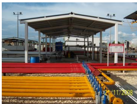
Figura 17. Casa bombas y al fondo, centro de control de máquinas.
