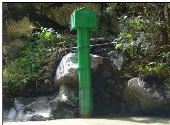
Figura 8-2. Limnógrafo Estación San Luis, ubicada sobre el río Guatiquía. Fuente EAAB.
