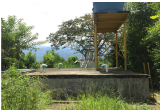
Imagen 3. Tanque de almacenamiento. Fuente propia.
