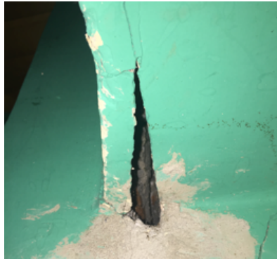
Imagen 12. Grieta transversal en muro. Fuente propia.
