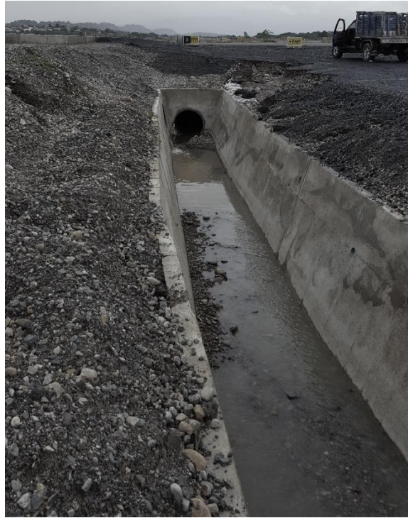
Ilustración 7. Alcantarillado Aeropuerto Camilo Daza-Cúcuta Fuente: Archivo fotográfico Imsaguas
