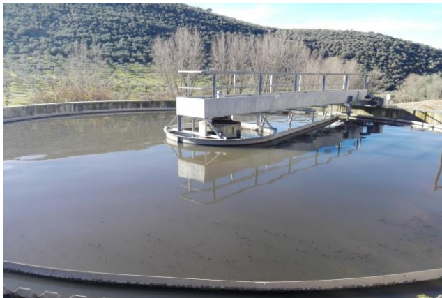
Figura 9. Decantador secundario. Fuente: DTD
