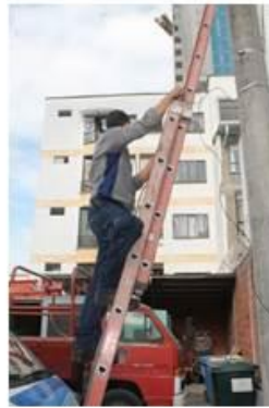
Colaborador subiendo la escalera sin eslinga.
