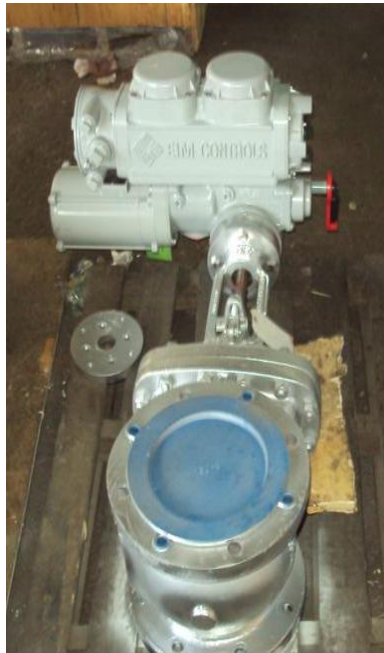
Figura 38. Montaje Actuador a válvula terminado. [3]
