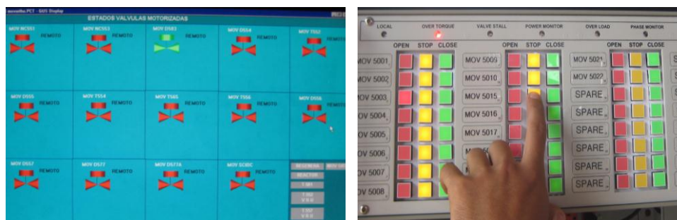
Figura 64. Verificación de Alarmas en DCS y Estación Maestra. [3].
