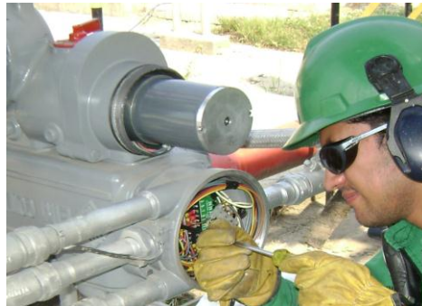
Figura 63. Conexionado de Acometida de Potencia y Comunicaciones. [3].
