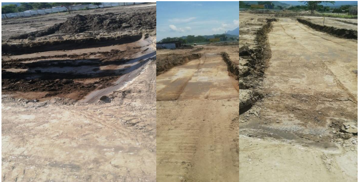
IMAGEN 15. REGISTRO FOTOGRAFICO DE LOS FALLOS 6,7 Y 10.
